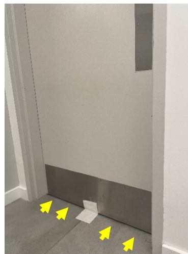
Figura 8. Vista desde el interior de una sala de presión positiva.
