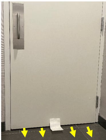
Figura 7. Vista desde el interior de una sala de presión negativa.
